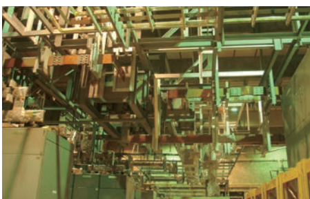
実験室送電線
