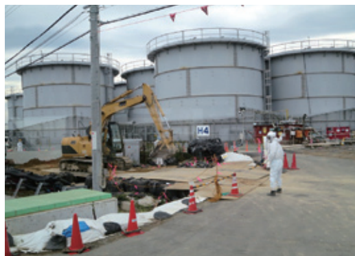
写真4 汚染水貯蔵タンク（ボルト留めの旧型。溶接構造の新型タンクに順次交換中とのこと。）
